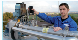
Messung am Faulturm
